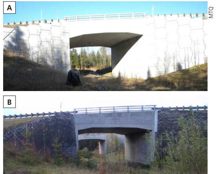
Figure 5. Photo illustrant l'éblouissement causé par le revêtement poli des murs d'ailes du premier portique du passage du ruisseau Doyon (A) et photo du revêtement en pierres fragmentées des murs d'aile du second portique du passage du ruisseau Doyon (B).
