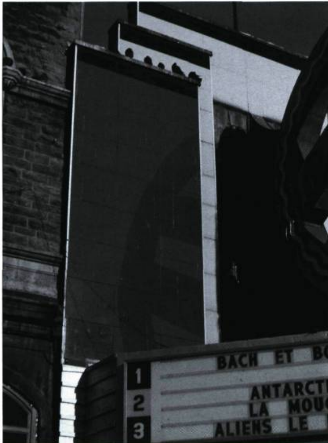
La façade du cinéma de Paris, rue Saint-Jean, à Québec, est revêtue en partie de panneaux de verre. Photo: François Varin.
