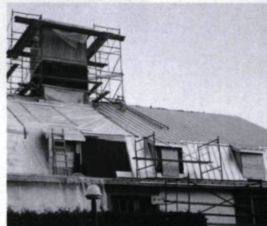
La rénovation et l'aménagement de la meunerie insuffleront une nouvelle vitalité au centre d'interprétation de l'histoire des Patriotes de 1837-1838.
