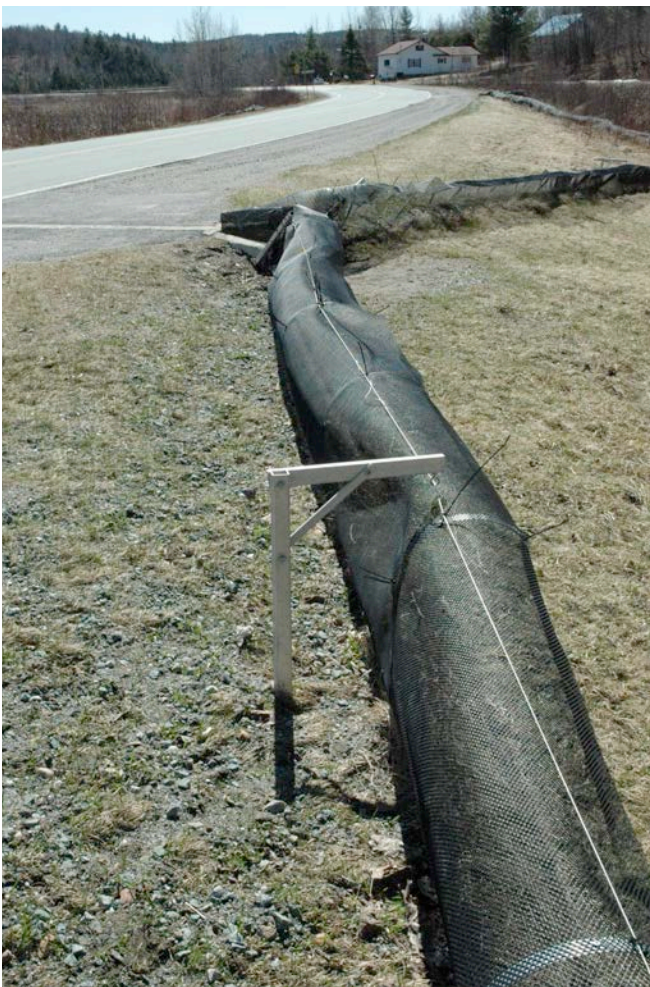
Figure 4. Clôture de déviation qui permet aux amphibiens d'être redirigés vers le tunnel.
