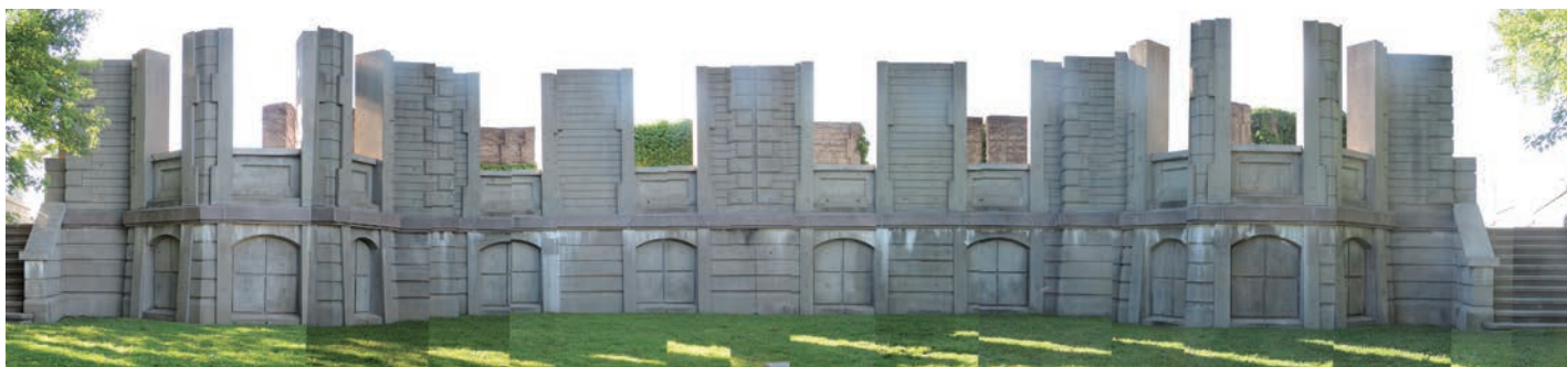
Montage de différentes prises de vue de l'arcade montrant l'état de détérioration de l'œuvre, notamment les traces blanches de calthémite.
