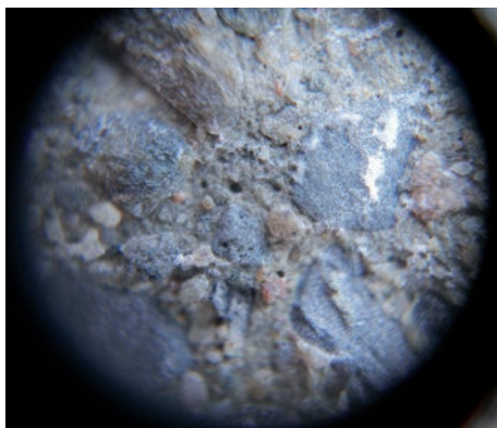
Des infiltrations d'eau répétées créent des dépôts de calthémite à la surface du béton. Source : EVOQ Architecture
