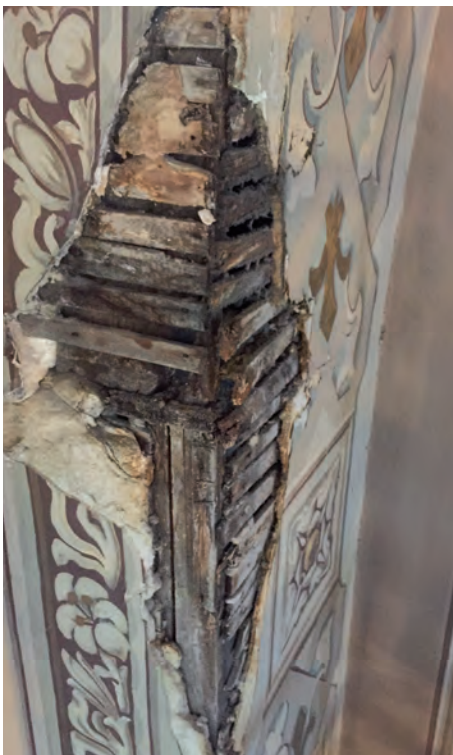
Des infiltrations d'eau ont entraîné le détachement de l'enduit à la chaux de sa base en lattis de bois.
