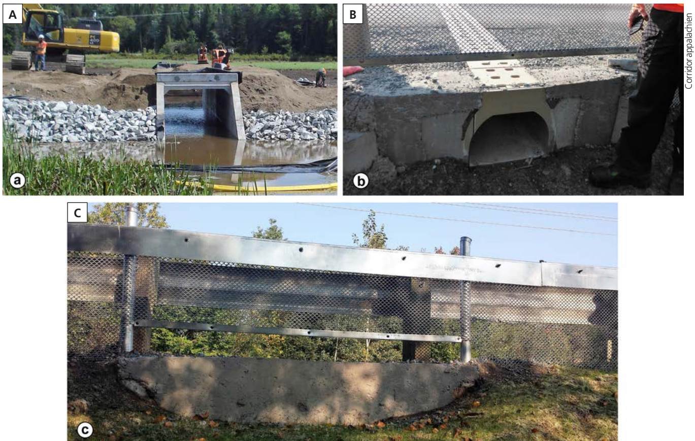
Figure 2. Photographies du passage à tortues de la route 245 à Bolton-Est: a) ponceau préfabriqué en béton; b) tunnel préfabriqué en béton polymère; c) clôture de déviation et échappatoire.
