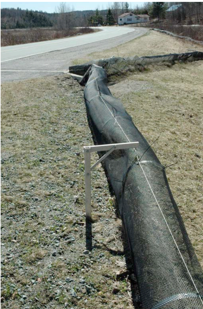
Figure 4. Clôture de déviation qui permet aux amphibiens d'être redirigés vers le tunnel.
