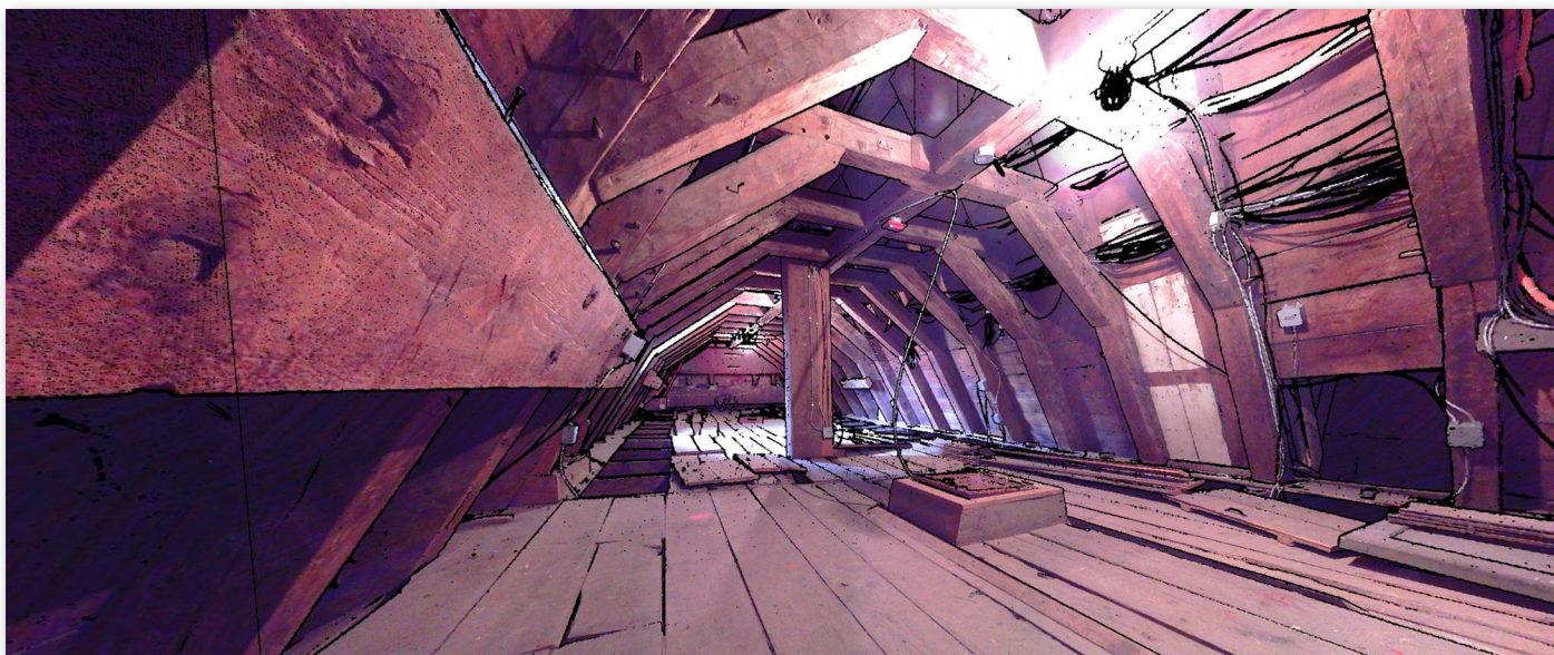
Charpente de l'église du monastère de l'Hôpital général de Québec. Numérisation : 3D ISCAN, avril 2018.
