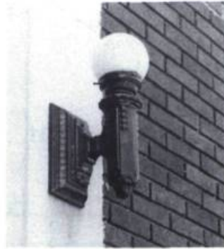
Applique de fonte installée contre l'encadrement de pierre de l'entrée et pourvue d'un globe de verre opalin simple et discret. Ce luminaire éclaire l'entrée des bâtiments des années 1920 et 1930. (photo: François Varin)
