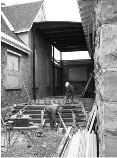
Ouvriers à l'œuvre pour la construction de l'escalier menant au nouvel accueil vitré, 2010.
