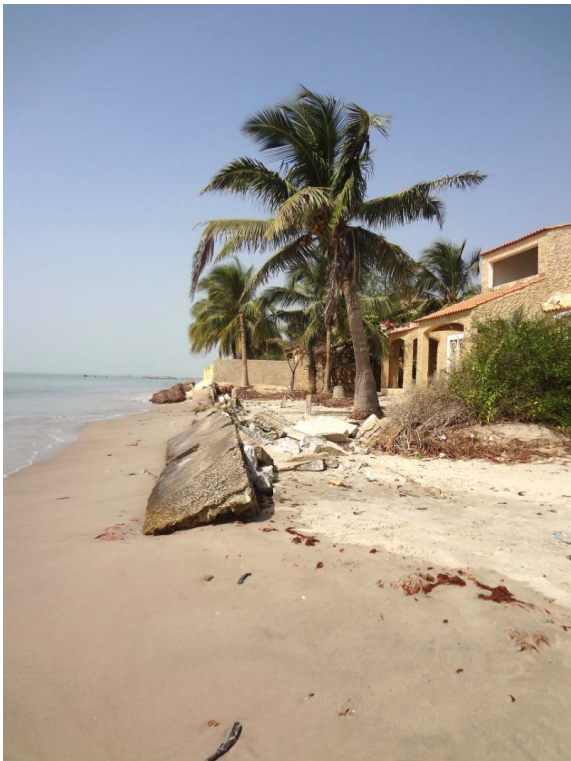
Figure 4. Une maison menacée à Joal.
