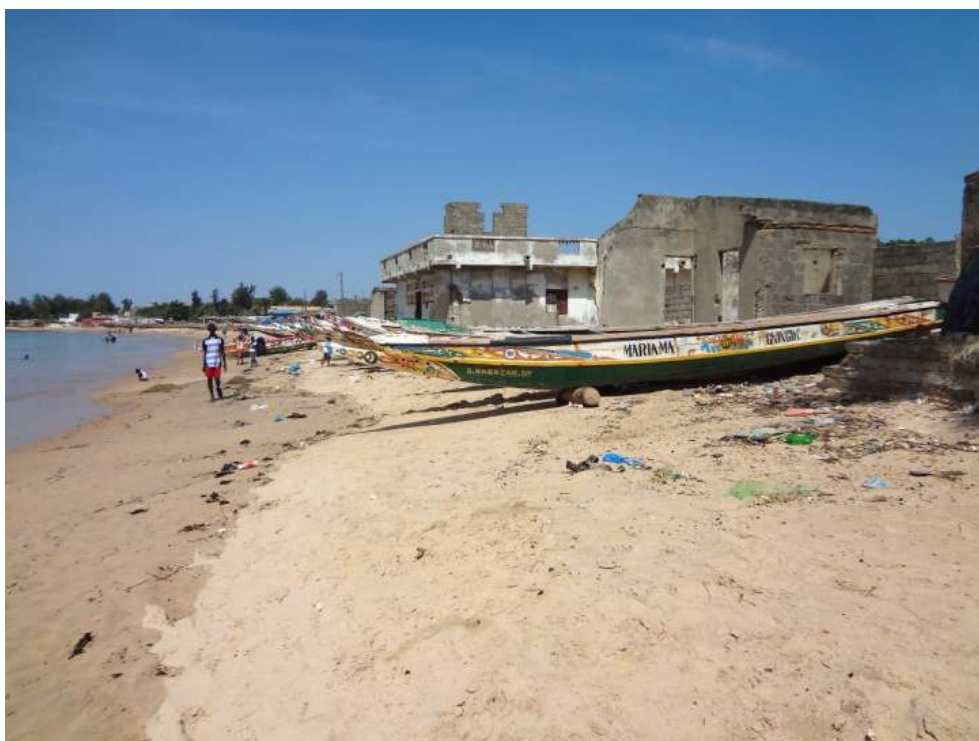
Figure 5. Érosion de la plage contribuant à la réduction de l'espace pour les pirogues et à la dégradation des maisons à Mbour.
