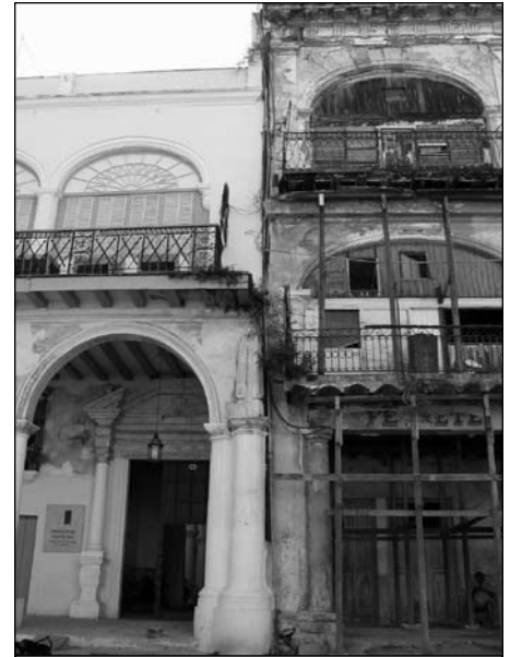
Illustration 5 : Deux états de conservation des bâtiments, quartier historique de la Vieille-Havane, Cuba.
