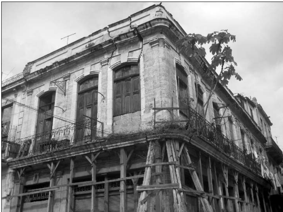
Illustration 2 : Édifice en état d'effondrement, Vieille-Havane, Cuba.
