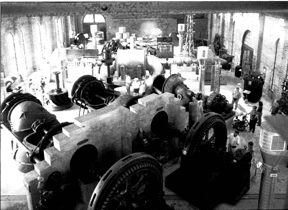
L'exposition de machines dans la centrale NAC. Photo : Cité de l'énergie.
