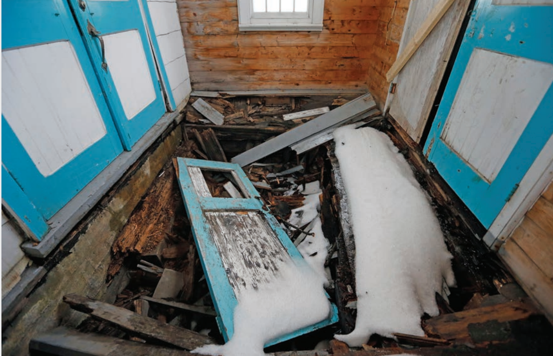
L'entrée principale est placardée, car le plancher du portique est complètement défoncé (Photo Pascal Huot, avril 2018)
