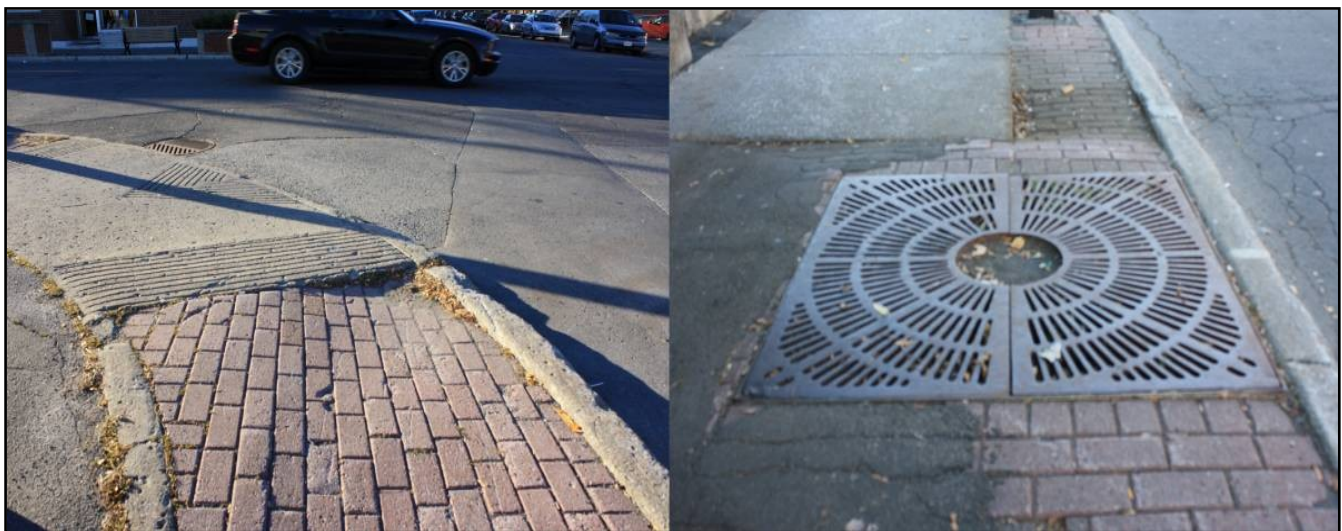
FIGURE 6 : IRRÉGULARITÉS DU TROTTOIR SUR LA PROMENADE MASSON
