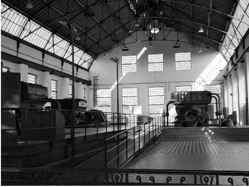
Figure 8. Hall pour la production d'air comprimé dans l'ancien charbonnage de Winterslag (Genk). © Patrick Viaene
