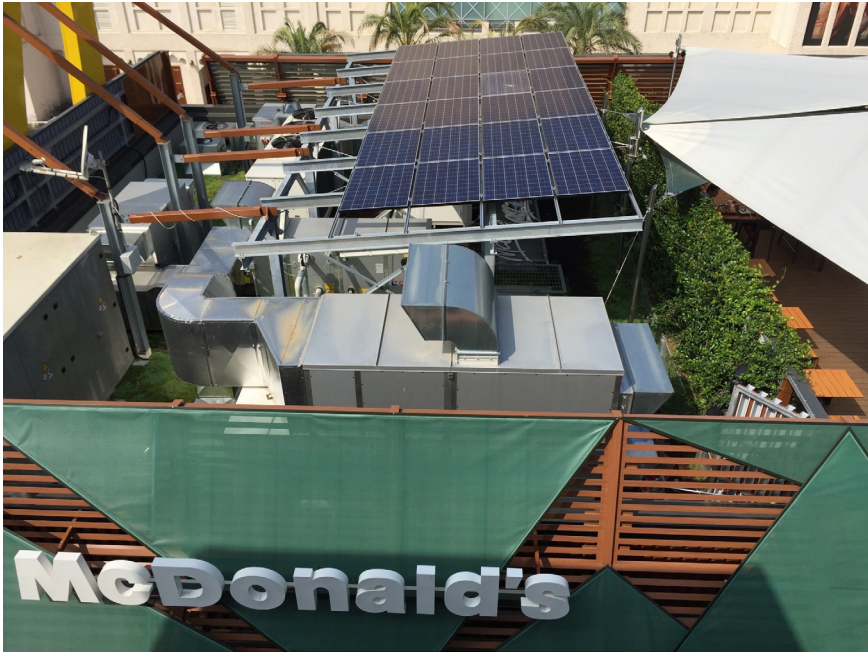
Figure 10. Les panneaux solaires du pavillon de McDonald's. Photo : Van Troi Tran, 2015.
