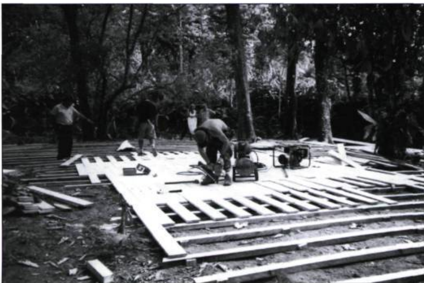
Ci-dessus et page suivante : sous la supervision du directeur artistique Serge Bureau, la construction d'un village au Costa Rica pour le film Le Papillon bleu PHOTOS : SERGE BUREAU
