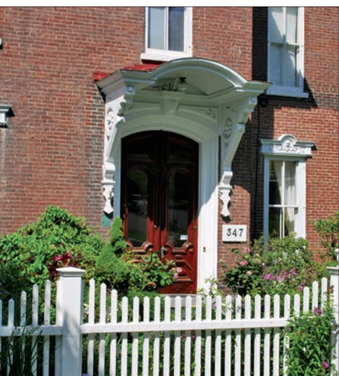
La marquise protège tant les résidents que la porte et son encadrement de la pluie.
