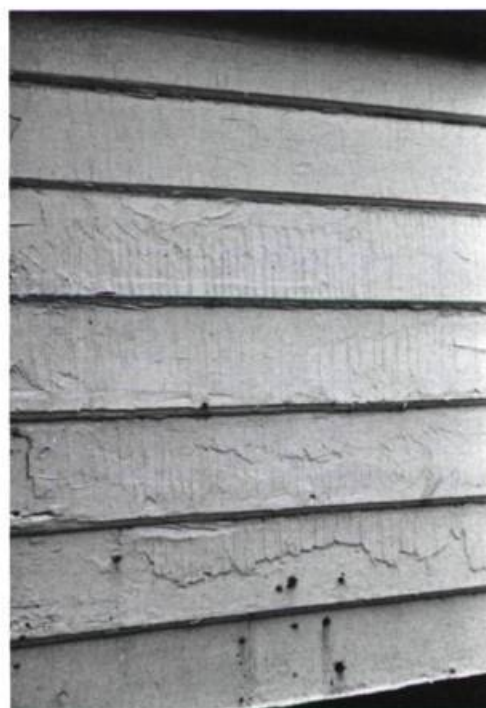
D Un grattage inadéquat pose non seulement un problème esthétique mais crée aussi une surface irrégulière favorable à la pénétration d'humidité derrière les couches de peinture.
