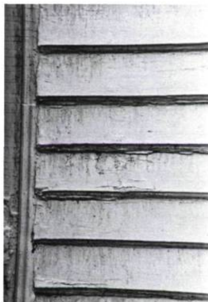
H Une trop grande accumulation de couches de peinture rend parfois difficile la lecture de la mouluration et l'appréciation des détails architecturaux. Il faut questionner la nécessité de toute nouvelle couche de peinture.
