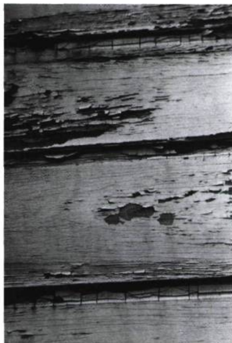
F La peinture qui pèle, l'écaillage et le fendillement jusqu'au nu du bois commanderont un décapage et un grattage importants.
